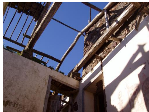
Fig. 1 – Evidência do estado de degradação do edifício antes da intervenção
