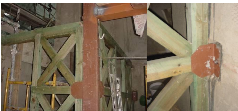
Fig. 4 – Ligações das estruturas de madeira das paredes de frontal às paredes de alvenaria existentes e às novas estruturas
