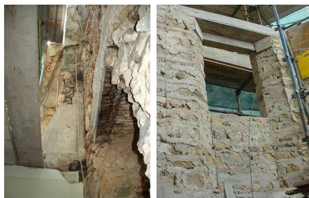
Fig. 1 - Estado de degradação das paredes no Lote 82. Reconstituição das paredes
