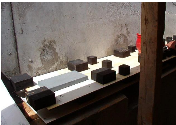
Fig. 3 - Apoios antivibráticos incluindo “failsafe system”
